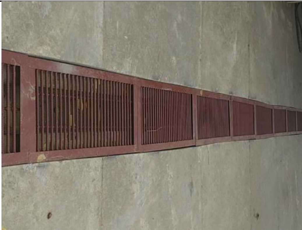
Hình 3. 2. Mương thu gom nước mưa khu vực nhiễm dầu
