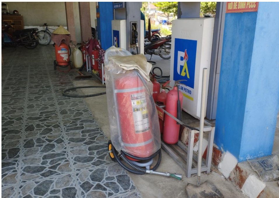
Hình 3. 9. Bình chữa cháy tại cơ sở
